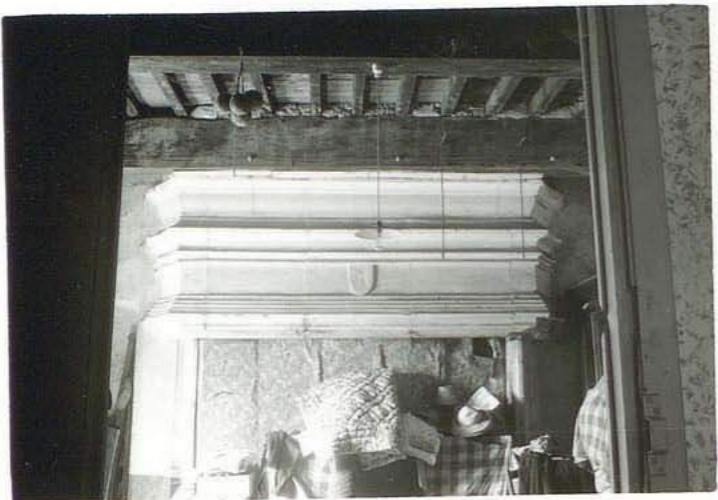
11572 Maison Laverde cheminée chambre
