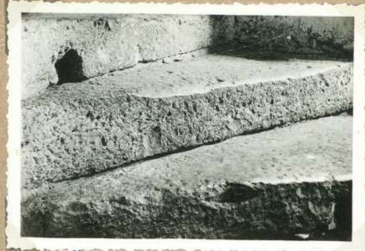
4323 Château de Cénac Mauvaises de l'escalier
