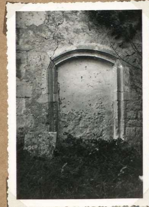
5472- Ch eau - Porte d'entrée murée, côté cover
