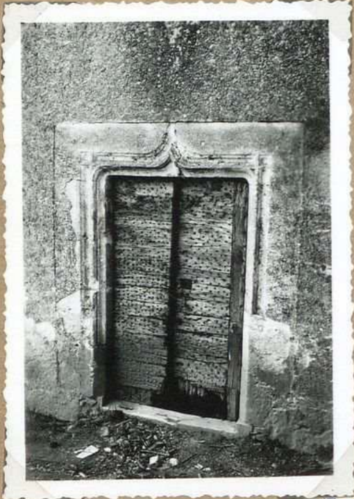
9088 Ch eau de Labastide M. Porte d'accès à l'escalier à l'ext érieur
