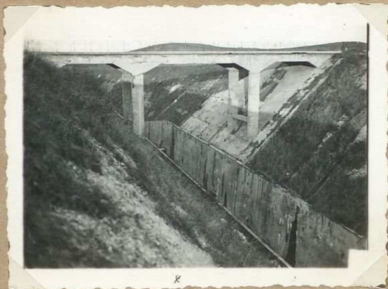
5965 ligne Calous-Marnac pont du Clezel
